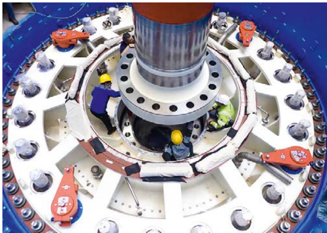
水力発電設備A-1の水車シャフトとガイドベーンの設定
