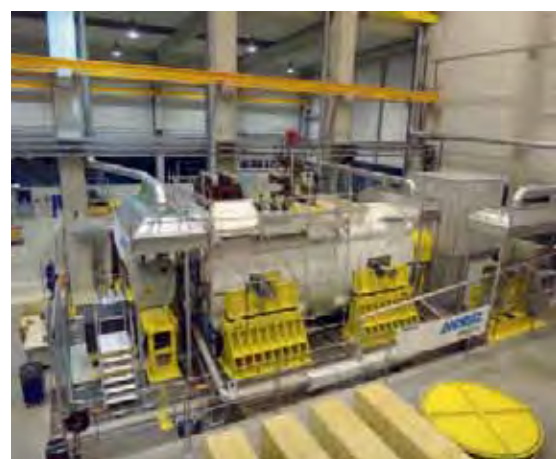
Turbogerador resfriado a hidrogênio no campo de testes
